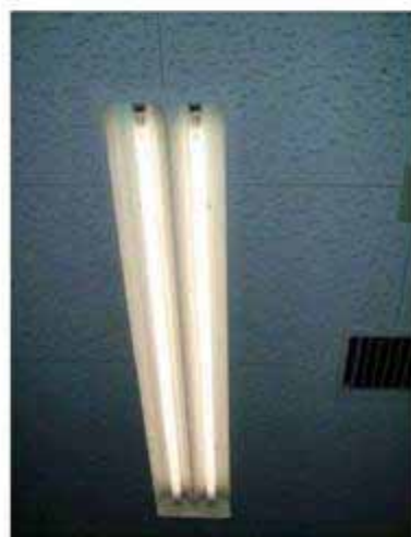
事務室 H型蛍光灯
