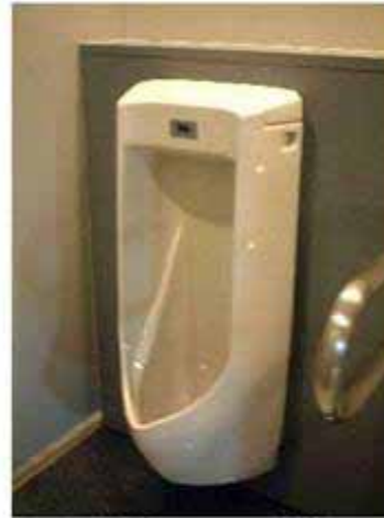
小便器センサー式洗浄システム
