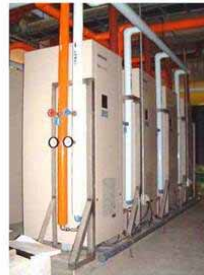
機械室設置 貯湯タンク
