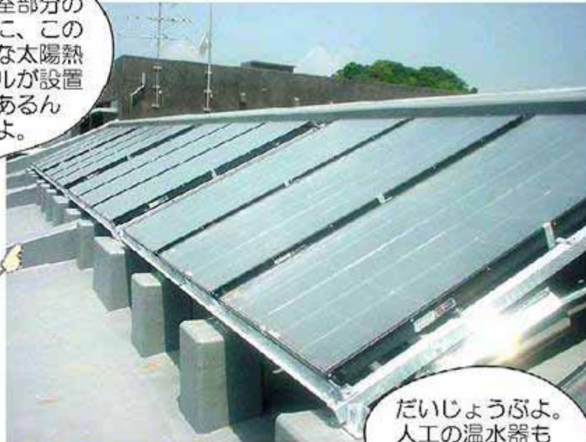
屋上設置 太陽熱集熱パネル
