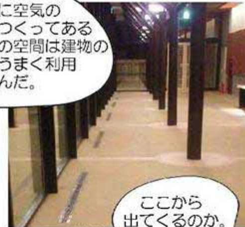
メインホール床吹出口
